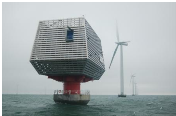
Pav. 1. Jūros vėjo elektrinės ir elektros pastotė Danijoje
